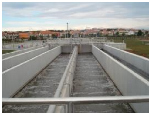
Slika 2.2. Aerirani mastolovi u pogonu za pročišćavanje otpadnih voda [6]
