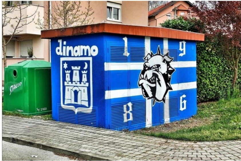
Slika 4. Oslíkana trafostanica na Borongaju
