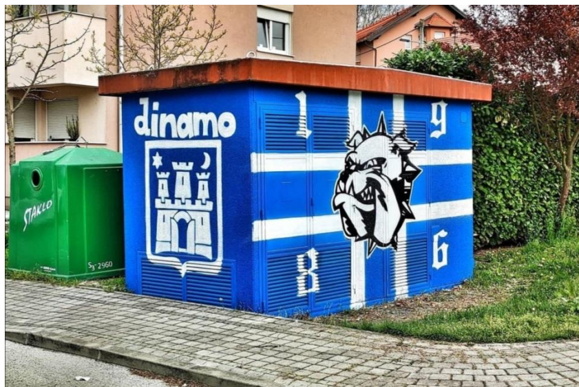
Slika 4. Oslíkana trafostanica na Borongaju
