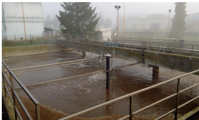
Slika 2.5. Aeracijski bazen u pogonu z pročišćavanje otpadne vode [11]
