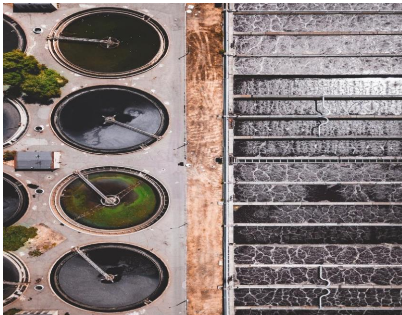
Sl. 3. Prikaz bazena s otpadnim vodama [7]
