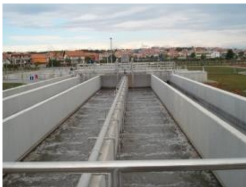
Slika 2.2. Aerirani mastolovi u pogonu za pročišćavanje otpadnih voda [6]
